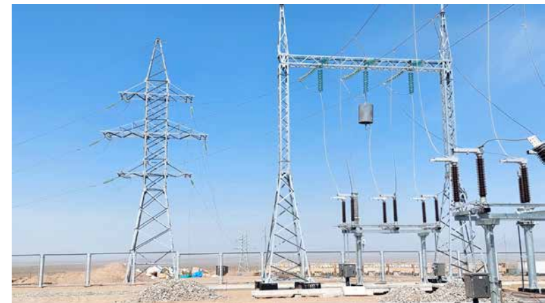
110KV 升压站出线门型架及出线塔
