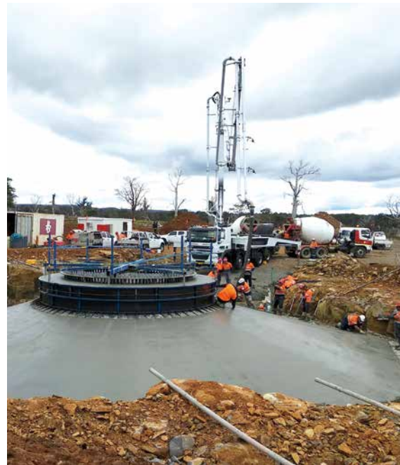
电建海投公司牧牛山风电项目建设现场
