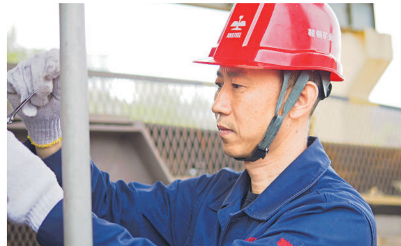
马志刚正在处理矿运中控室减速机电机故障。
