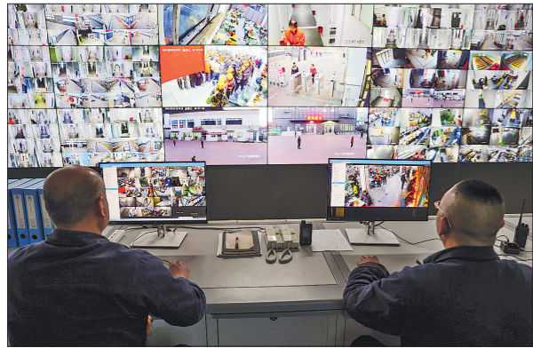
3月20日,在北京城市副中心站“建设者之家”的消防中控值班室内,两名值班员盯着屏幕,保障工地安全。
