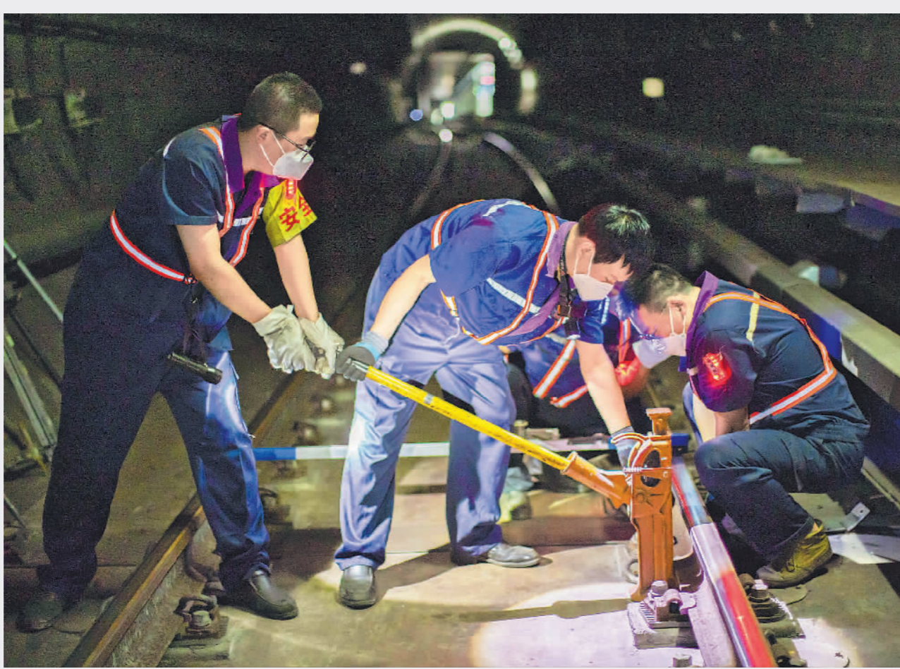
9月21日深夜的北京地铁7号线,在距离地面30多米的一处隧道内,北京地铁线路分公司综合维修9项目部的城市轨道交通检修工正在进行轨距、水平测量并进行整治。每天深夜,等最后一辆列车驶进站场后,北京地铁各维修部门的轨道检修工就开启了繁忙的检修工作。无论寒冬还是酷暑,他们守护着轨道交通的平稳运行,被形象地称为“轨道医生”。 本报记者 王伟伟 摄
