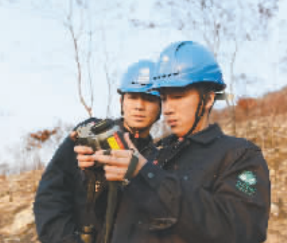
巡线人员用红外测温仪检测线路设备
