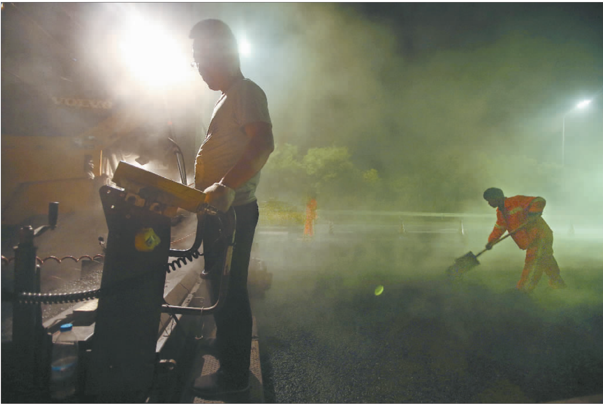
6月29日1点51分,北京东五环附近京通快速路上,工人们抓紧时间给高速路铺沥青。施工时间是凌晨1点到5点,每天只能铺设不到1公里。夏天溽热的夜晚,工人们要忍受100多摄氏度沥青的烘烤,有时还要站在滚烫的沥青上作业。
