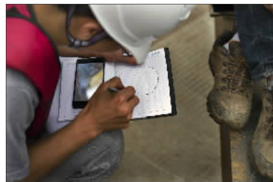
5月30日,这位技工正在通过手机资料计算全国最大的桥梁钢筋笼的焊接点及其位置。
