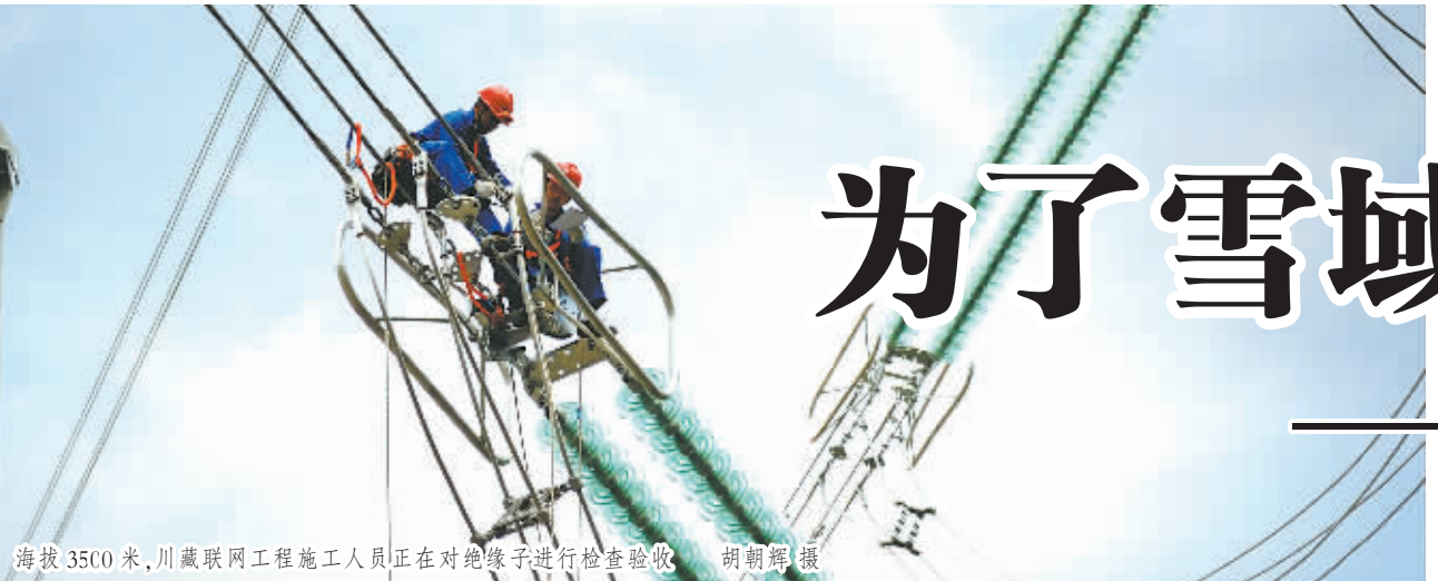
海拔3500米,川藏联网工程施工人员正在对绝缘子进行检查验收。胡朝辉摄
