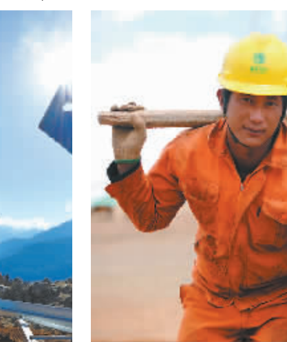
川藏联网工程包9标段铁塔组立现场,员工正在共同搬运塔材。叶海平摄
