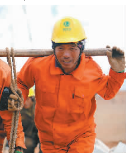
川藏联网工程包9标段铁塔组立现场,员工正在共同搬运塔材。叶海平摄
