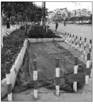
鸿运佳苑小区附近一处冒臭气的下水道被地膜覆盖。 本报记者 李娜 摄
