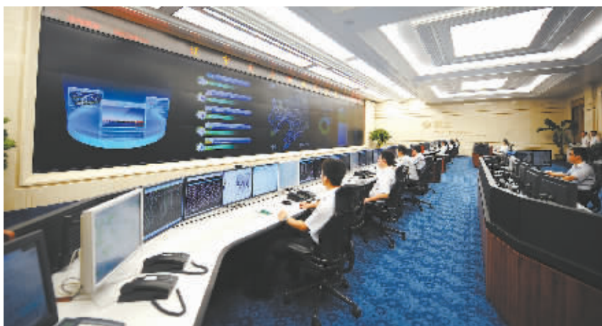
现代化的电力调度系统
