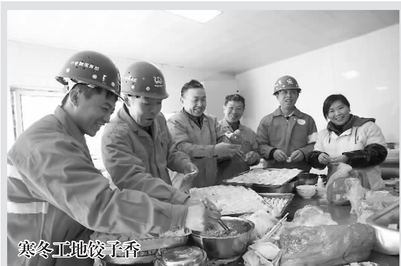
寒冬工地饺子香 日前,河北省石家庄地铁一号线人民广场站项目工区,天气寒冷,施工困难,但工人仍坚持一线工作。中铁隧道集团把温暖送到工地,如图,工人们正在包饺子,其乐融融。 赵晶 摄
