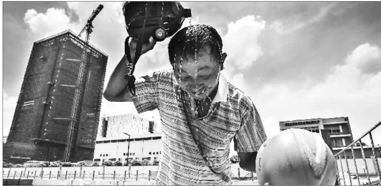
广东佛山,烈日炎炎,上午下班后,在广佛地铁二期工地作业的工人朱国才向头上浇水降温。 东方IC
