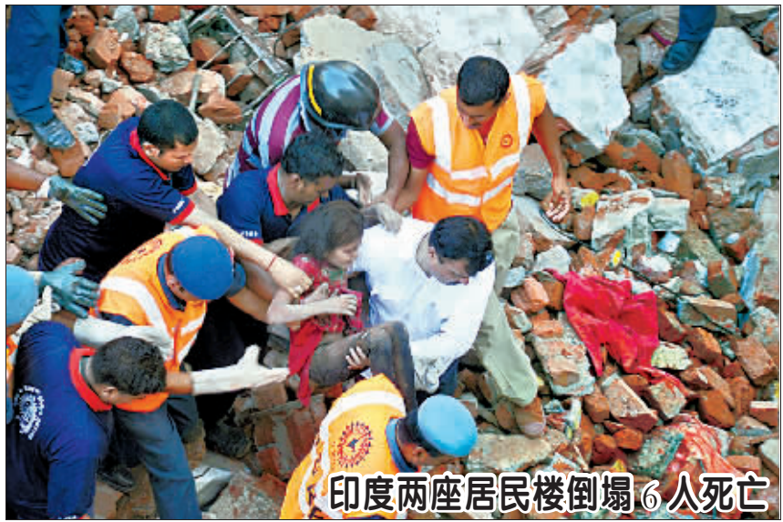
8月28日,在印度西北部古吉拉特邦瓦多达拉市,救援人员在楼房倒塌现场救出一名幸存者。印度西北部古吉拉特邦瓦多达拉市两座居民楼28日凌晨倒塌,目前已造成6人死亡,至少35人被埋。
