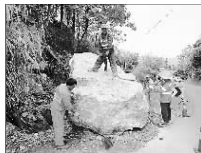
两天清除 36 吨塌落巨石
