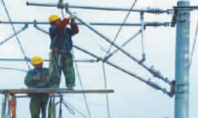
由电务工程公司承建的上海地铁10号线,提前开通,为世博会提供交通便利。图为职工们正在进行腕臂装配。
