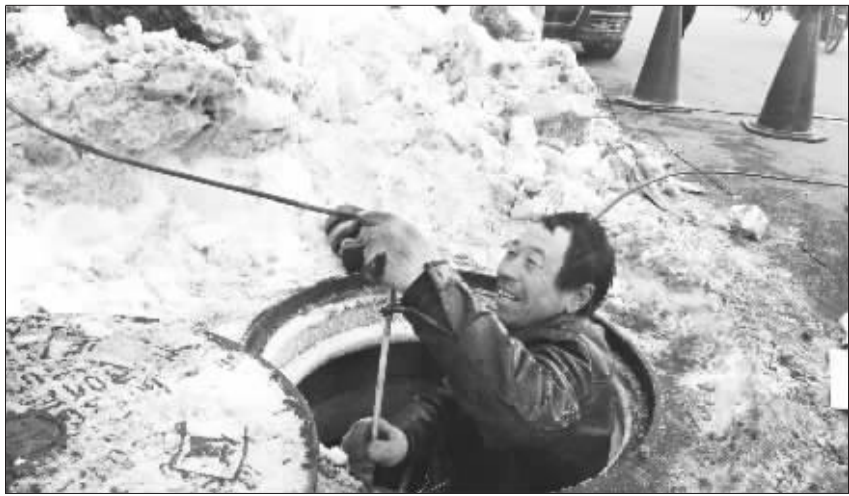
1月15日,北京安外大街,52岁的电信工人张连弟开创冰雪在冰冻的井下工作,他已经连续干了7天。连日来,北方地区出现了近年罕见的低温天气,为保证通信工程畅通,电信职工们在艰苦恶劣的环境下辛勤忙碌。本报记者 许之丰 摄
