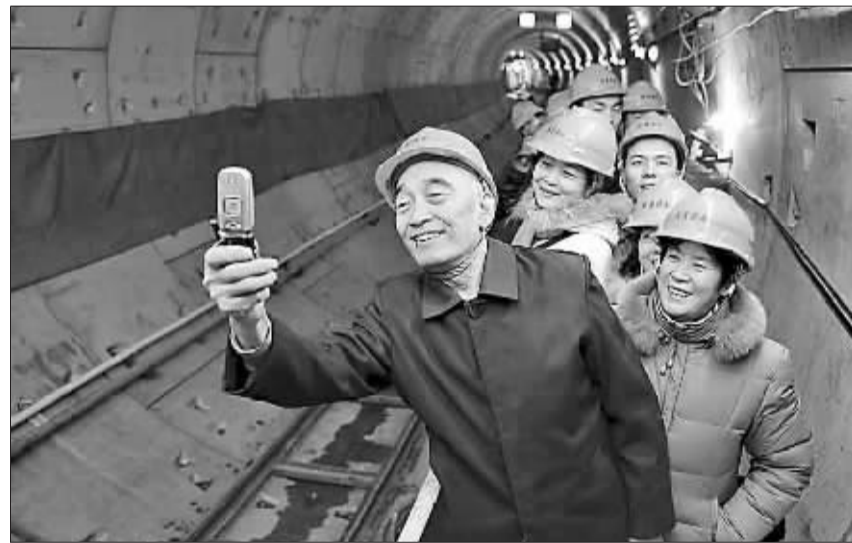
12月14日,首批参加“市民看地铁”活动的40名市民走进了郑州地铁七里河站的地铁隧道。“郑州一号”“郑州二号”的快速掘进以及建设职工的风采让参观者惊叹不已。目前掘进速度最快的“郑州一号”盾构机已掘进了近200米。 小白摄
