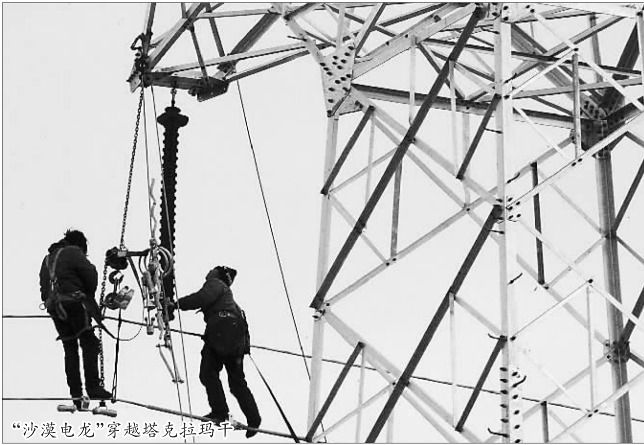
“沙漠电龙”穿越塔克拉玛干 工人们在塔克拉玛干沙漠腹地的高压线路铁塔上作业(12月9日摄)。一条穿越“死亡之海”塔克拉玛干沙漠的220千伏输电线路正在加紧建设。线路北起塔克拉玛干沙漠北缘的轮台县,一期工程到达沙漠腹地的塔中油田,全长322公里,总投资10.12亿元。工程建成后,将实现向沙漠油气产区供电的任务,未来还将解决地处沙漠南缘的且末、若羌等县的用电问题。
