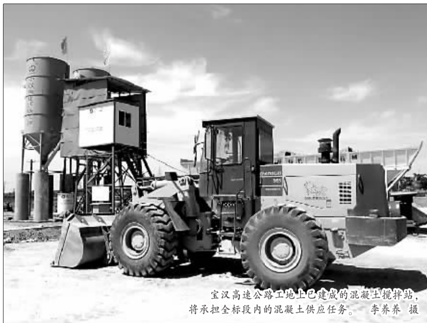
宝汉高速公路工地上已建成的混凝土搅拌站,将承担全标段内的混凝土供应任务。李养斌 摄
