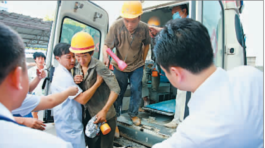
6月7日下午15时50分左右,三亚绕城高速公路迎宾隧道塌方事故现场救援通道终于被打通,8名被困人员全部被救出,并送往医院治疗。这8名工人是在6月4日23时建设海南省三亚市绕城高速公路迎宾隧道时,发生塌方事故被困于隧道里的。孙清摄
