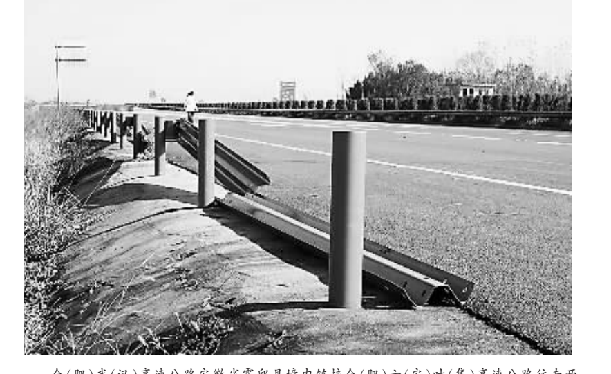
合(肥)武(汉)高速公路安徽省霍邱县境内链接合(肥)六(安)叶(集)高速公路往南两公里内的公路护栏和防护网被盗、损毁现象相当严重，护栏根基的螺丝、螺母不翼而飞，护栏随时会塌落。安徽省 刘容海 摄
