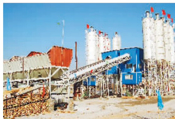
大型混凝土拌和站
