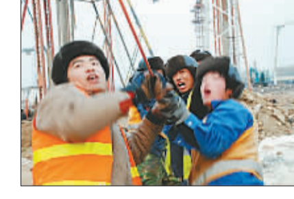
日前,全国规模最大、技术装备世界一流的新建北京动车段一期四电工程已全面竣工,预计将于12月31日进车开通。
