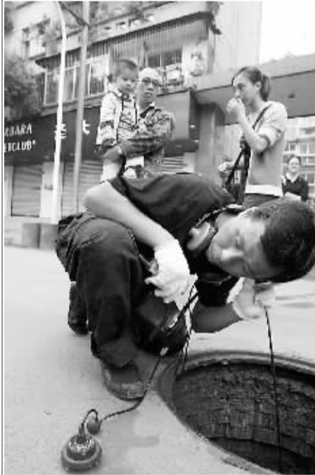
▲5月25日,在震后的都江堰市,工作人员正在探测生活用水管道的破损情况。汶川大地震发生后,一大批高科技设备被运往灾区,投入抗震救灾和灾后重建工作中。本报记者 杨登峰摄
