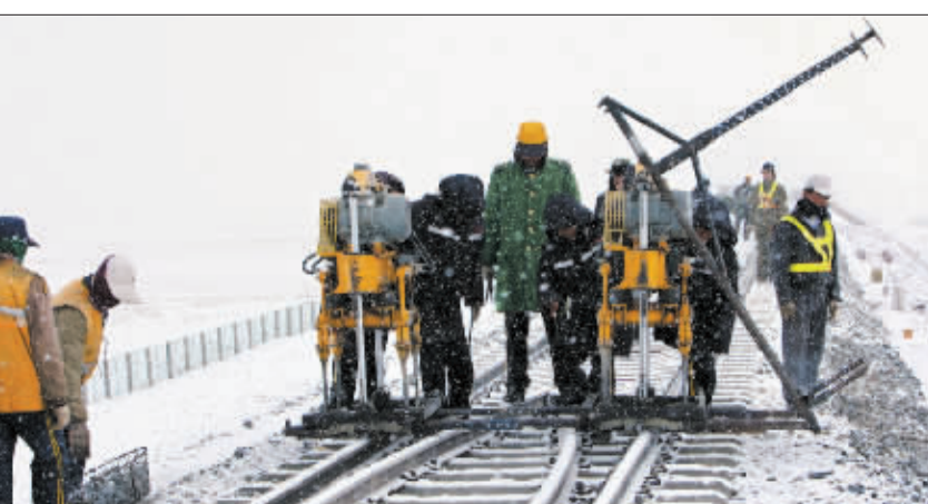
入冬以来,西藏北部地区出现多次降雪冰冻天气。负责铁路养护的职工克服重重困难,对青藏铁路线路设备进行精心养护。这是铁路养护公司员工在海拔5000多米的唐古拉山一带清理青藏铁路铁轨冰冻。(12月9日摄) 新华社发(杨斌摄)
