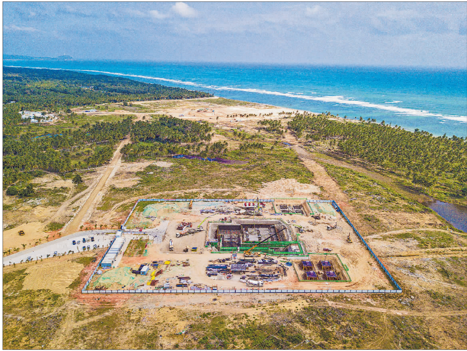
图为12月28日在海南省文昌市拍摄的建设中的海南商业航天发射场一号工位。目前,我国首个开工建设的商业航天发射场——海南商业航天发射场正在紧张建设中。该发射场位于海南省文昌市,由海南国际商业航天发射有限公司投建,致力于打造国际一流、市场化运营的航天发射场,进一步提升我国商业运载火箭发射能力。新华社记者 蒲晓旭 摄
